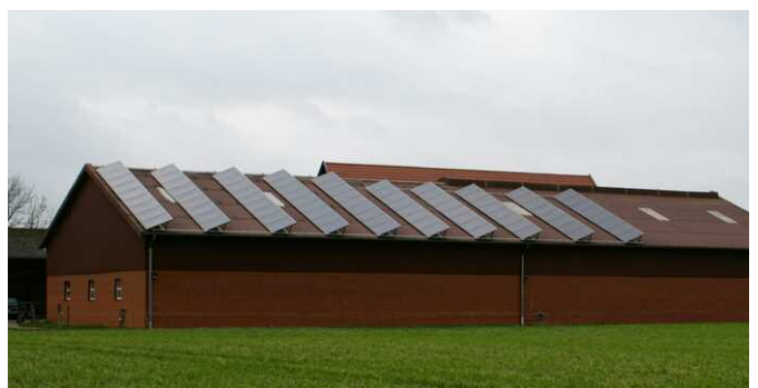
Aufgeständerte Solaranlage (&gt; 20 cm)
